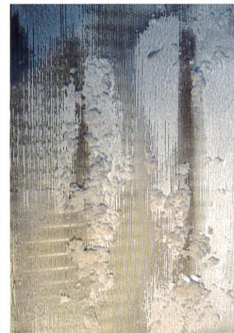
Massiv erhöhter Energieverbrauch durch völlig verstopfte Lüftungssysteme, verschmutzte Ventilatoren und Kühlbatterien ohne Luftdurchlass.
