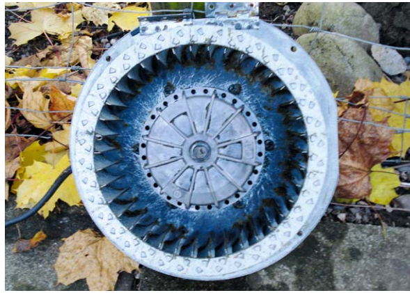
Total verfetteter und verschmutzter Küchenabluftventilator vor und nach erfolgter Reinigung.
