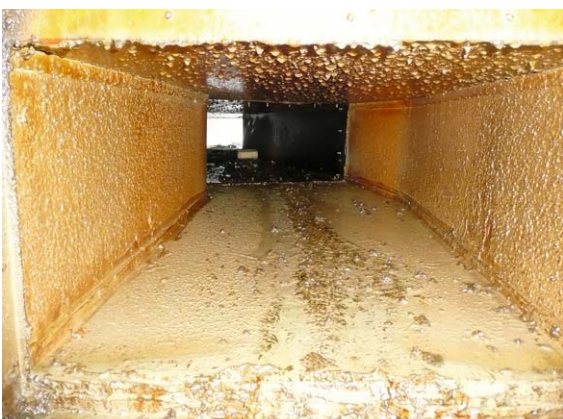
Sehr stark kontaminierter Lüftungskanal.
